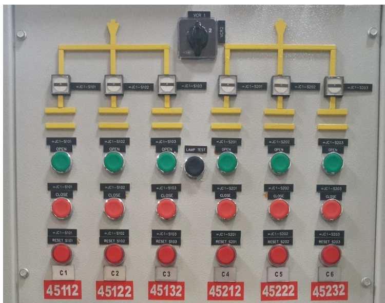
شکل ۳-۵ (۳) شستی‌های فرمان باز و بسته شدن کلید بانکها روی تابلو
